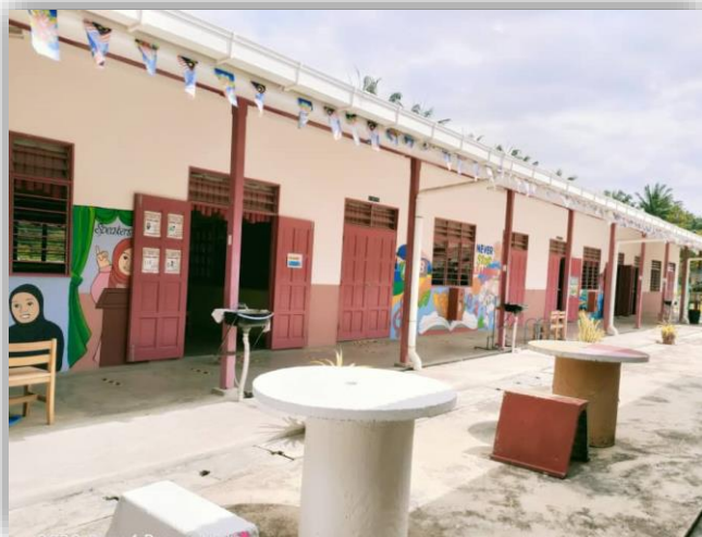
Program Pembaikan Sekolah Daif (Sekolah Kebangsaan Sungai Tuang, Masjid Tanah)
